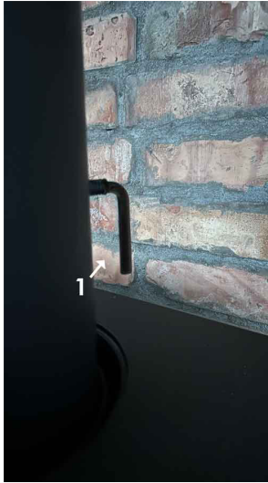
Regelschieber (1) des Ofenrohrs
